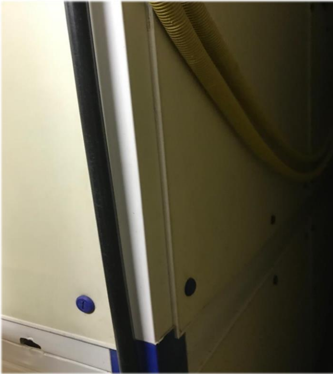
Figura 1 – Fan & Coil existente.
