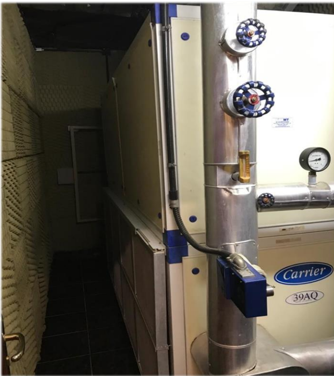
Figura 2 – Fan & Coil existente e Casa de Máquinas.
